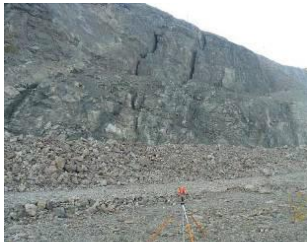
Рисунок 25 — Деформации западного борта Соколовского карьера
